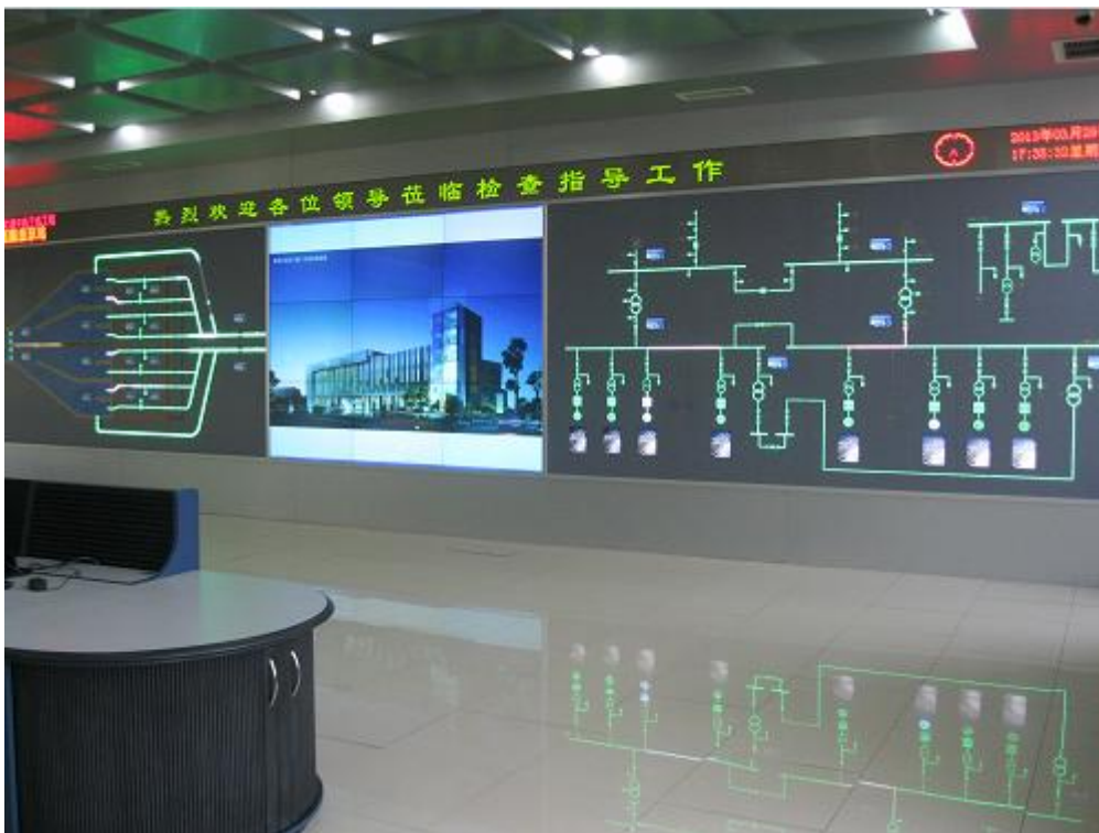
Figure 5 Le centre d'exploitation de la station de pompage de Huinanzhuang (site visité par la délégation française de haut niveau en Octobre 2013)
